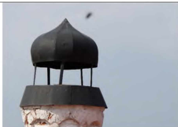
Трапезная. Металлический дымоход
