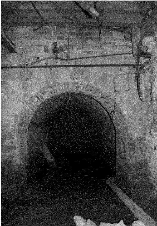
Видовая точка № 41. Помещение подвала (Нахановича пер., 3а) арочный проем и коробовый свод помещения (под лестницей 1-го этажа)
