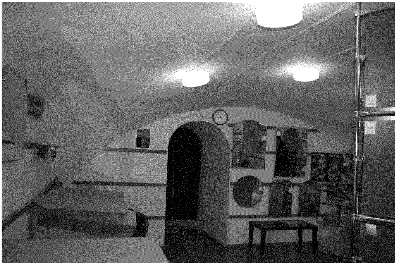
Видовая точка № 23. Кирпичные парусные своды в помещении подвала (автор снимка: Рыжикова А.Ю., дата съемки: 2016 г.)
