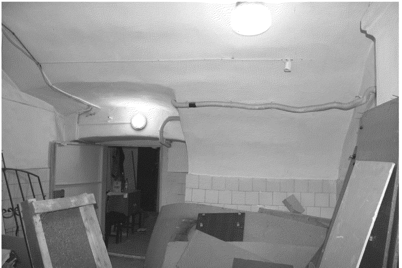
Видовая точка № 11 Помещение подвала с кирпичным сводом. Дверной проем с лучковой перемычкой.
