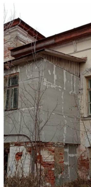
Фрагмент руинированной лопатки, выделенной кирпичной кладкой по углам пристройки (литера А1), северо-восточный, юго-западный фасады.
