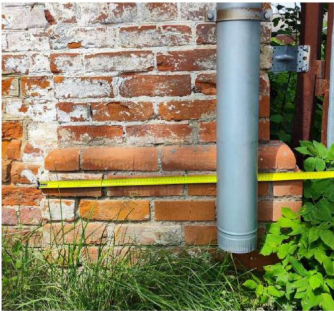
Главный южный фасад. Нештукатуренный цоколь, с незначительным выступом, с кромкой в виде полувалика. Гладкие широкие лопатки на углу.
