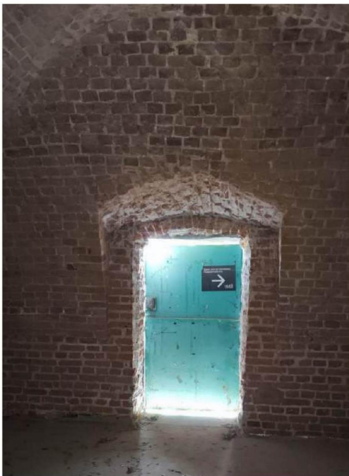
Первый этаж. Полулотковый свод. Распалубка над растесанным оконным проемом по главному фасаду.
