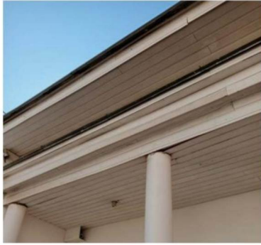
Фрагмент выноса кровли с деревянной подшивкой, фрагмент навеса с деревянной подшивкой сохранившейся галереи восточного объема здания.
