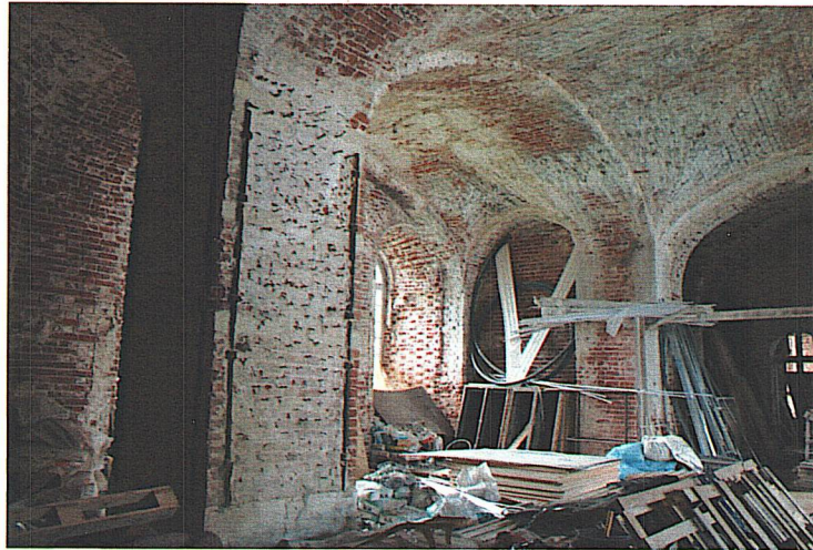
Подпружная арка северного нефа собора в нижнем ярусе, столп с металлическими сжимами
